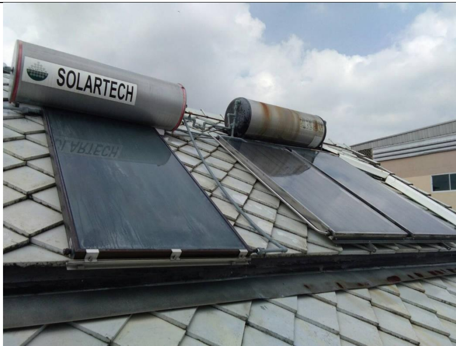
รูปที่ 2. 54 Example of Solar heat pump (Dormitory buildings)
