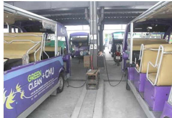
รูปที่ 2. 122 การชาร์จไฟฟ้าสำหรับรถไฟฟ้า
