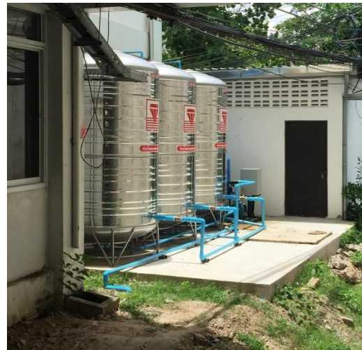
รูปที่ 2. 109 ตัวอย่างถังเก็บน้ำฝน ลิตร จำนวน 4,000 ถัง 3 (อาคารเรียนรวม RB5)
