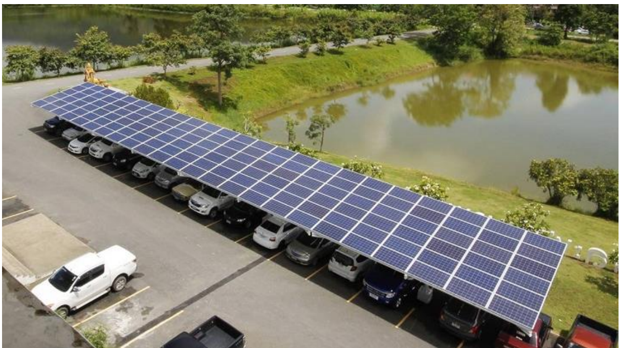
รูปที่ 2. 28 Solar rooftop in Parking area, CMU (Source: shot on 15 Feb 2018)
