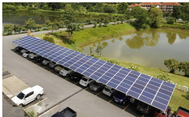
รูปที่ 2. 17 Example of Solar Roof (Energy Research and Development Institute – Nakornping)
